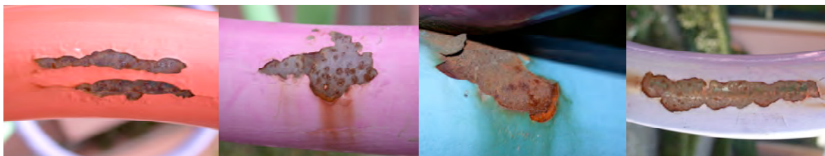
Photos 6, 7, 8 et 9 : Problème de corrosion et de mauvaise adhérence des couches de peinture sur le métal.
