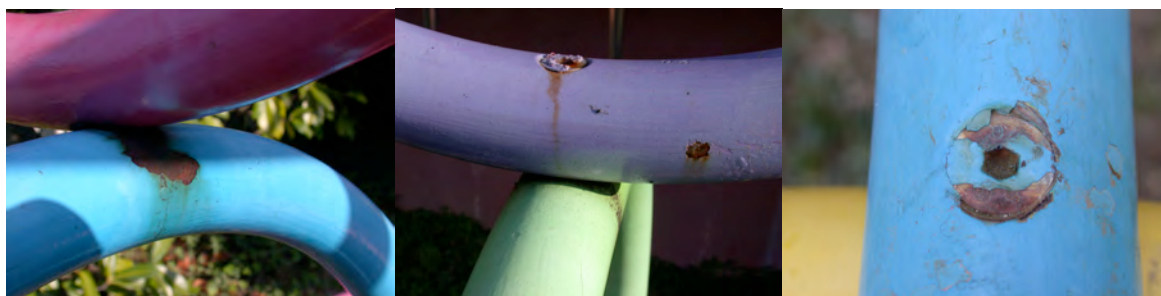
Photos 10, 11 et 12 : Problème de corrosion surtout localisée dans les zones d'assemblage et sur les visseries en acier inoxydable de mauvaise qualité.
