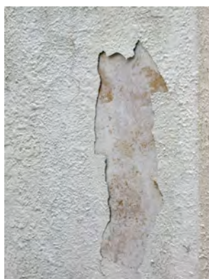
Photo N° 3 : Perte et soulèvement du revêtement (détail de 30 cm environ).
