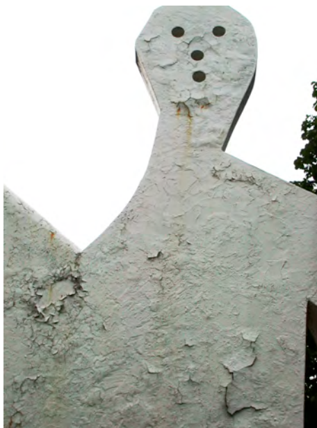
Photo N° 4 : état des dégradations en juin 2005.
