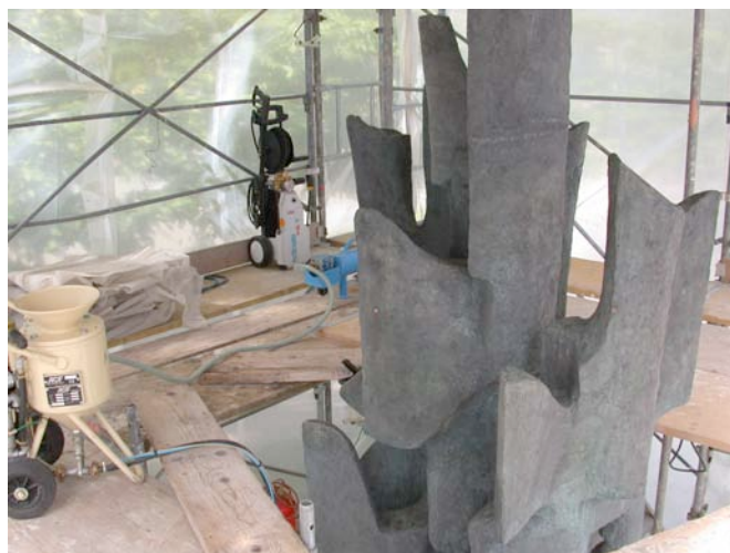
Photo 3: Innenseite der semi-wasserdichten Kabine, oberer Bereich während der Behandlung
