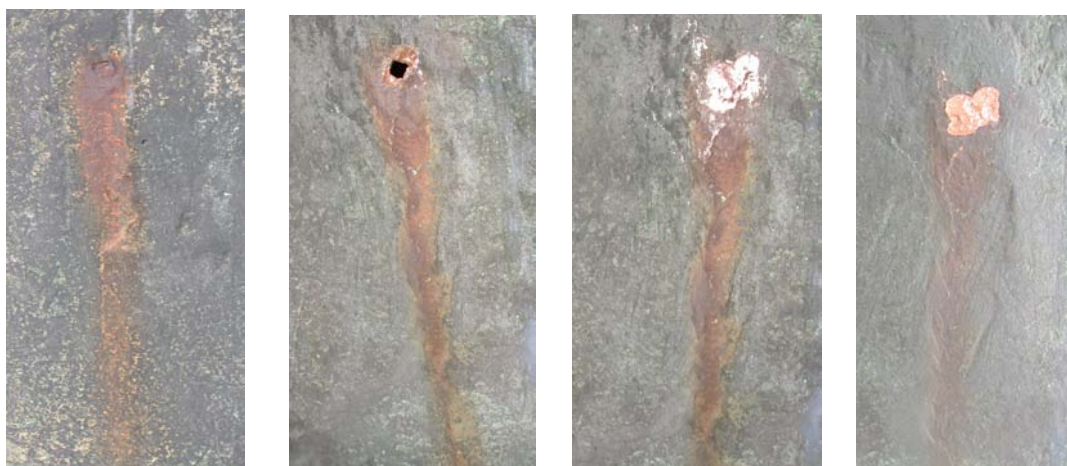
Photos 17, 18, 19 et 20: Eisenstab vor der Behandlung, nach der Bohrung, eingefügter und geschmiedeter Kupferstab, weniger deutliche Fliessspuren nach der Sandstrahlung
